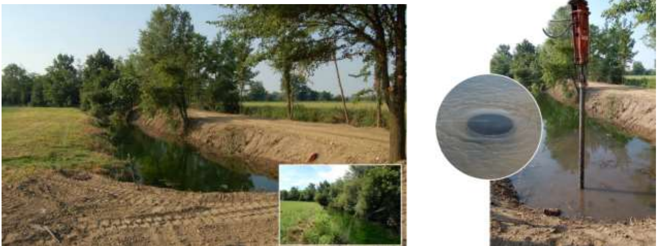
Fig.35 "Testa "ripulita e riprofilata e riposizionamento tubi emungitori del Fontanile Campociocci minore a Buccinasco (Mi) (ERSAF, 208)
