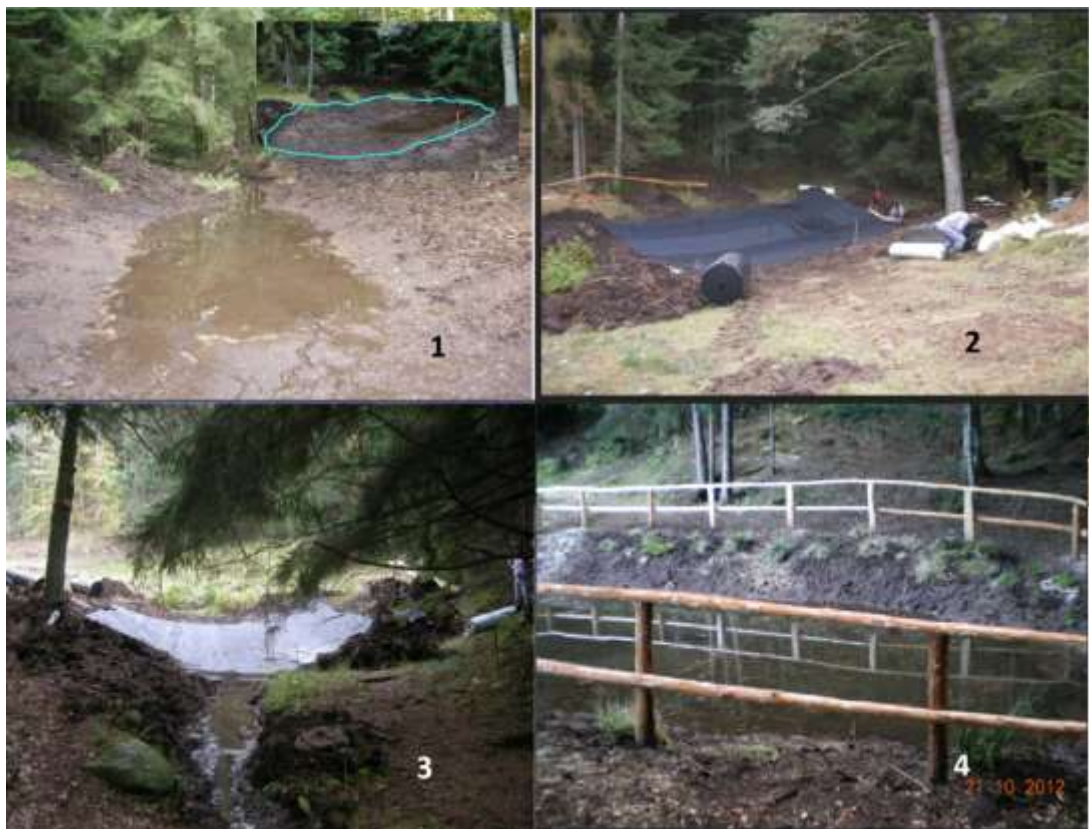
Pozza per anfibi impermeabilizzata in un impluvio per meglio raccogliere le acque con impermeabilizzazione (fig 2 e 3) e recinto di protezione dal bestiame (foto 4). Azzolo, Sondrio. (Foto Vincenzo Ferri)
