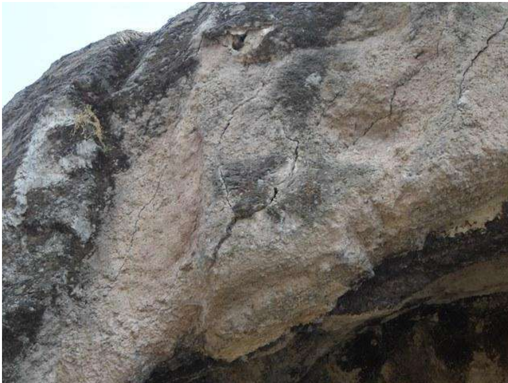
Figura.3 – Alcune delle crepe visibili all'esterno della grotta votiva, che determinano un rischio di crollo almeno parziale.
