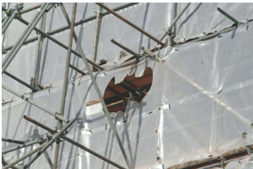
Varco realizzato fra le impalcature (English Heritage, National Trust and Natural England, 2009)
